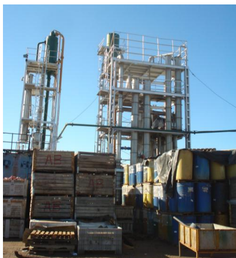
Figura 1: Vista del conjunto de concentradores
