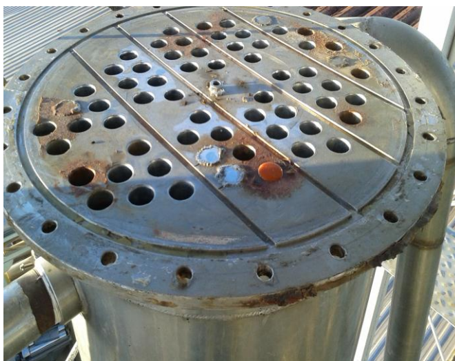
Figura 2: Estado de intercambiadores de calor
