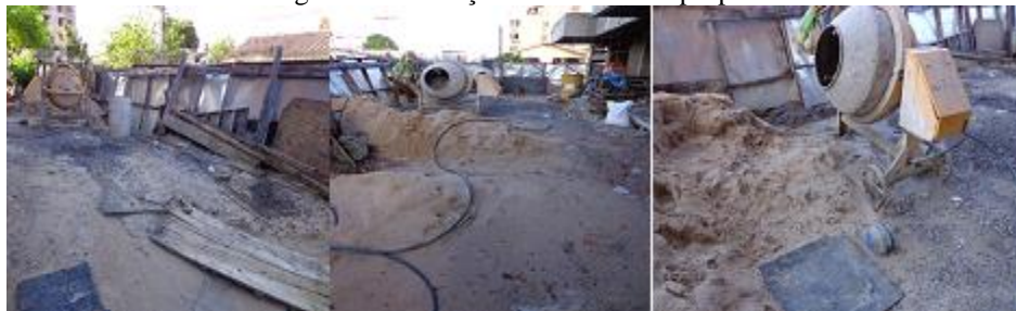
Figura 4 – Alocação de material imprópria
