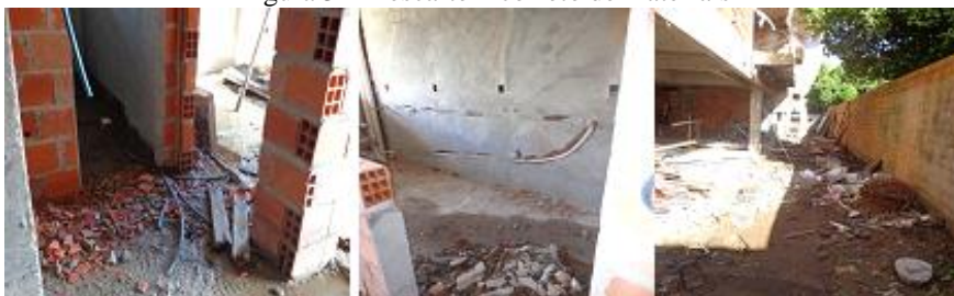
Figura 3 – Descarte incorreto de materiais
