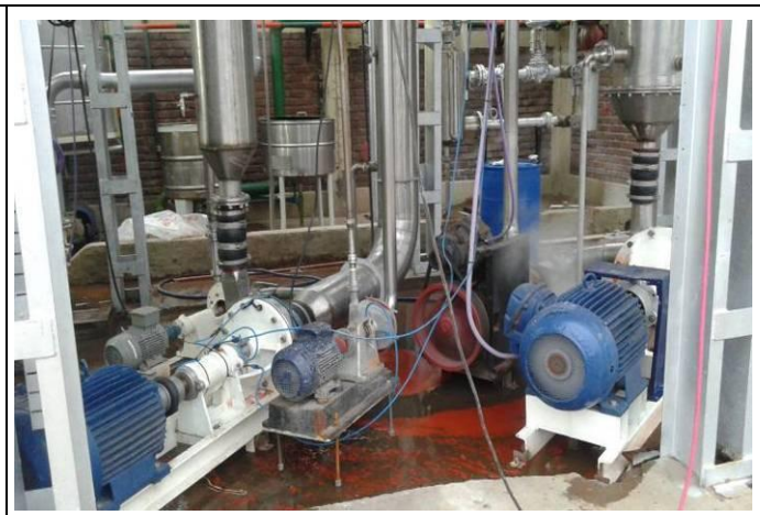
Figura 5: Bombas del evaporador Fuente Rubio y Asociados
