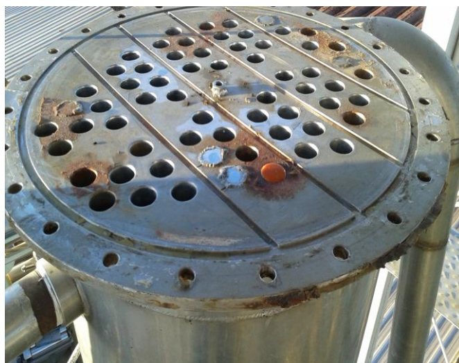
Figura 2: Estado de intercambiadores de calor
