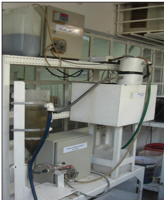
Figura 2. Planta Piloto de Lodos Activos Convencional con recirculación de lodos. Montada en FABRIPAR S.A
